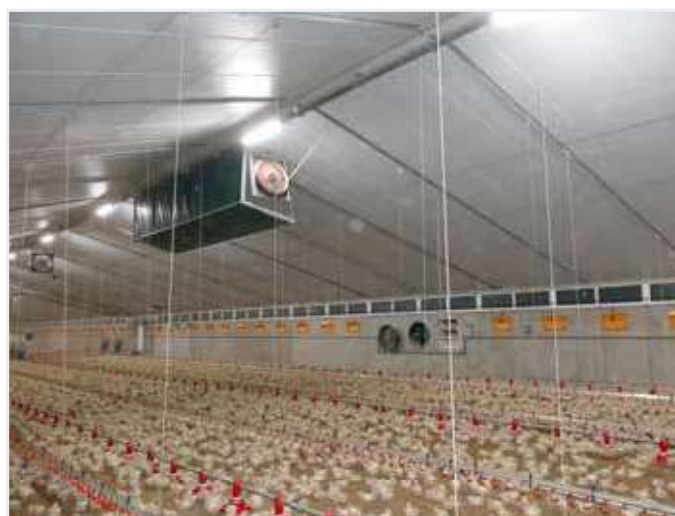
De ingeblazen lucht van de warmtewisselaars wordt 'opgevangen' in de nok en vandaaruit via circulatieventilatoren homogeen verspreid in de stal.
